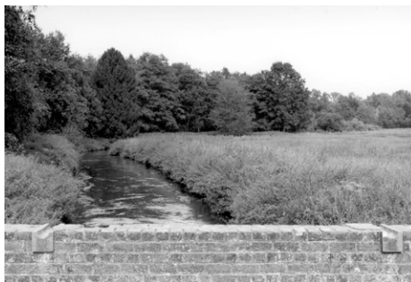
Rustbank op brugmuur
